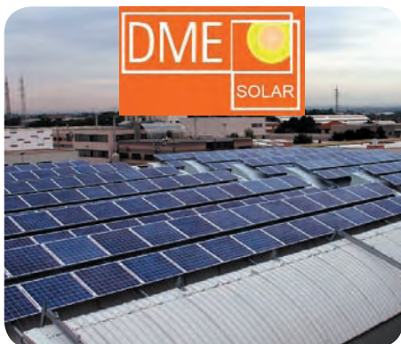
Realizzazioni DME SOLAR
